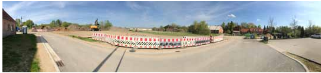
B-Plan Nr. 8 der Gemeinde Damshagen – Die Bagger sind angerückt. Die Erschließung der Baugrundstücke an der Alten Schmiede hat begonnen.
